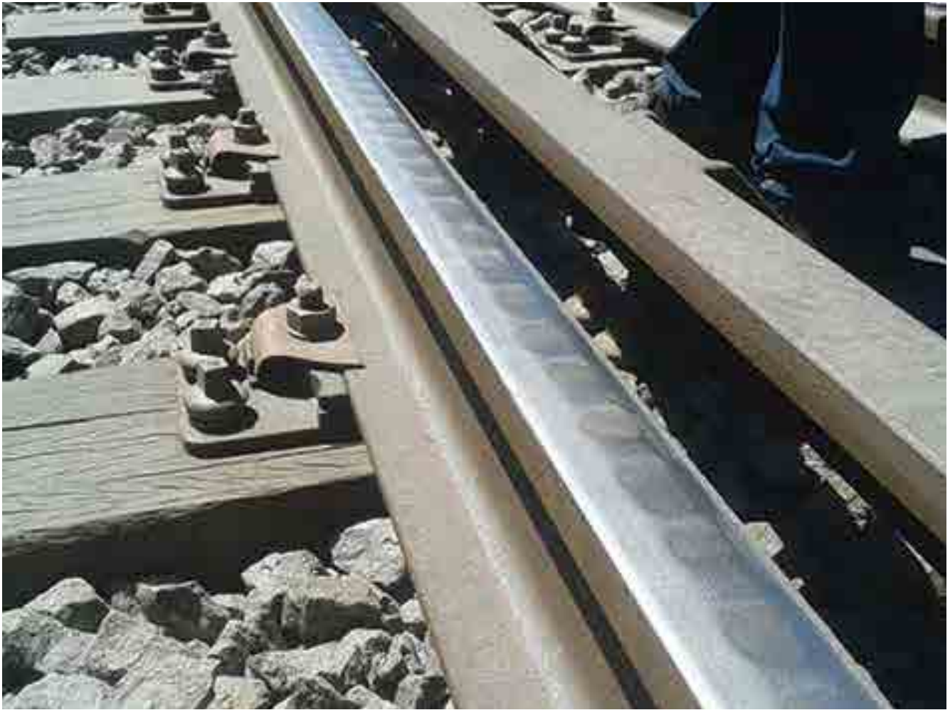
Sujeción de carril utilizada en la Línea 12 del Metro de Ciudad de México. Zonas con contra-raíl.
